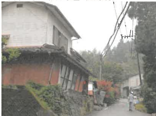
熊本地震の被災家屋（西原村）
