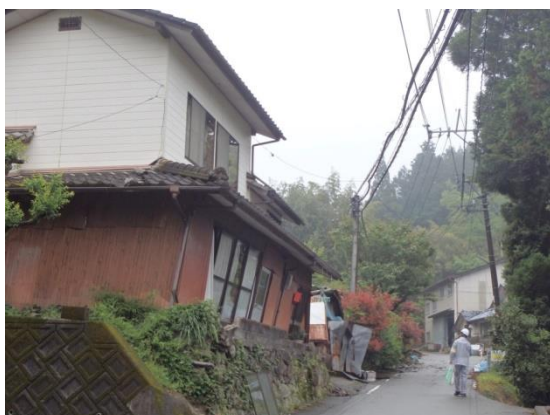
熊本地震の被災家屋（西原村）
